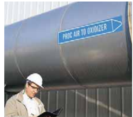
Marquage de tuyauteries
